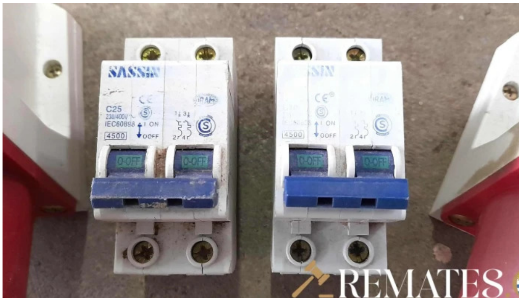
2 termicas 2 toma corriente trifasico 2
